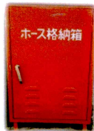
初期消火箱（ホース格納箱）
