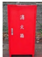
初期消火箱（固定式）
