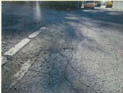
× 駐車場からの砂利流出の例
