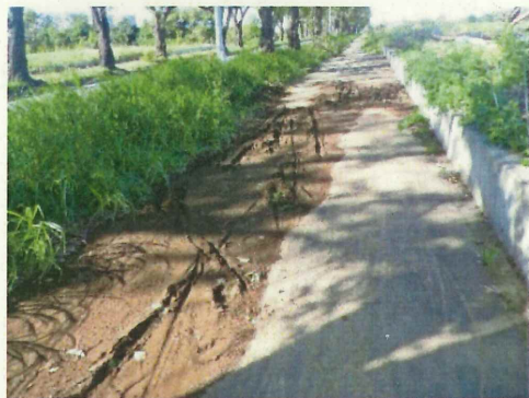
× 畑からの土砂流出の例
