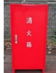
初期消火箱（固定式）
