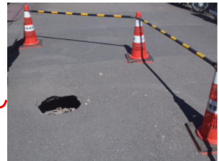
取付管破損に伴う道路陥没
