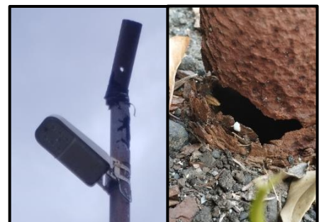
ポールの劣化事例
