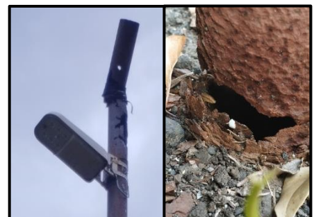
ポールの劣化事例
