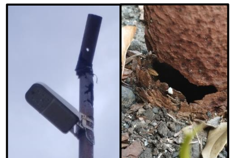
ポールの劣化事例
