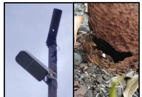
ポールの劣化事例
