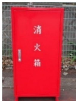
初期消火箱（固定式）
