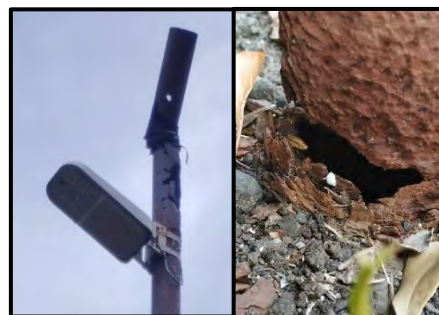
ポールの劣化事例
