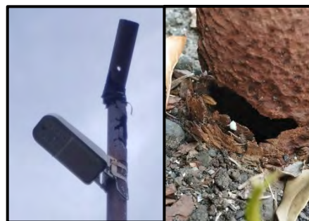
ポールの劣化事例
