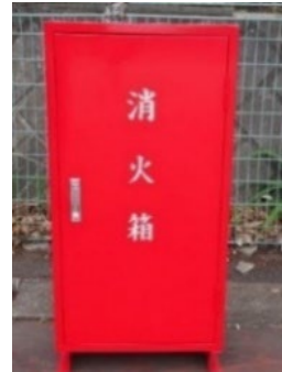
初期消火箱（固定式）
